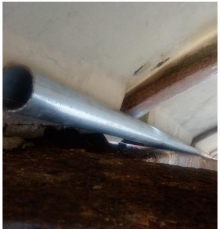
Figura 9: Eletroduto de aço galvanizado do tipo pesado fixado nas laterais da passarela
