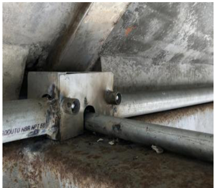
Figura 10: Caixas de passagem metálicas
