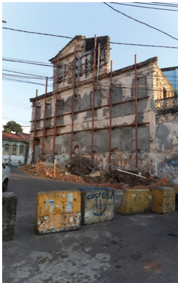
Prédio arruinado na Avenida Joana Angélica, Campo da Pólvora. Fotografia: Rafael Martins, 2023
