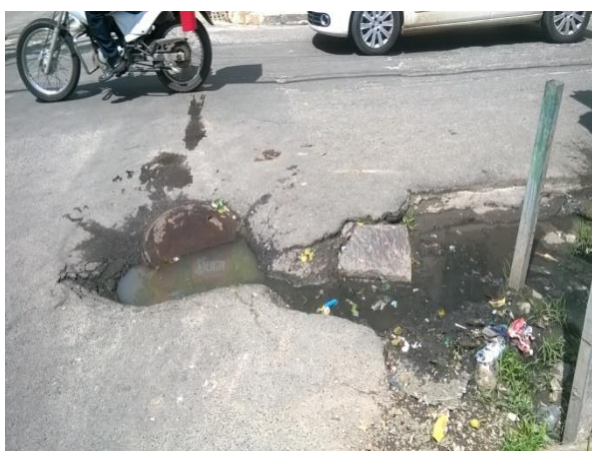
FIGURA 7 - Esgotos correndo em via pública
