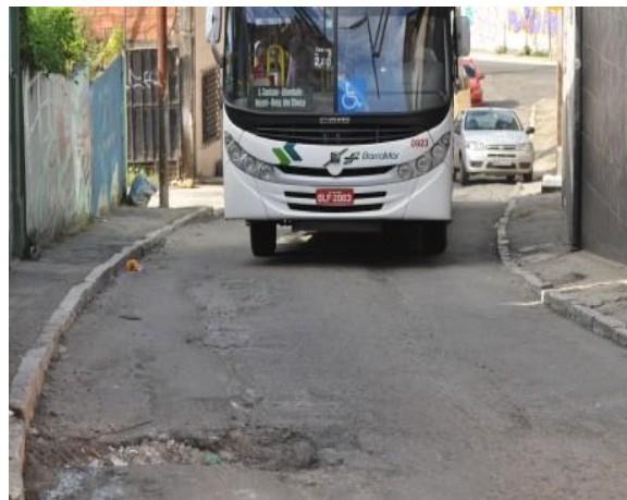
FIGURA 54 - Buracos na Rua S. José de Baixo - Liberdade
