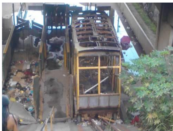
FIGURA 55 - Condições de abandono do Plano Inclinado Liberdade – Calçada
