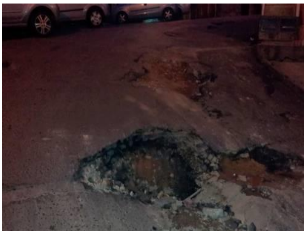
FIGURA 53 - Buraco na Rua Arapongas – Liberdade
