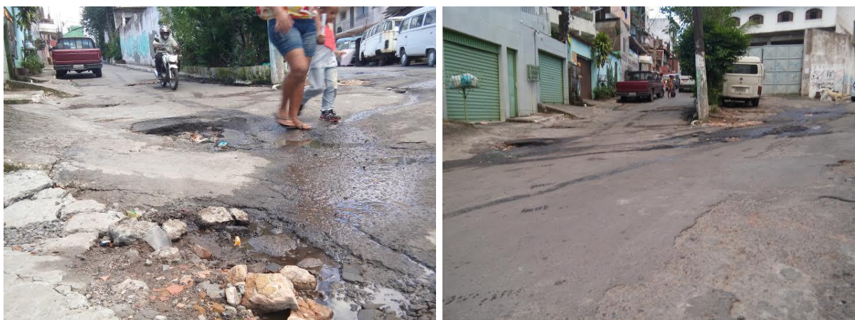
FIGURA 86 e 87 - Rua Vicenza Francisca. Buracos, asfalto e passeios deteriorados.
