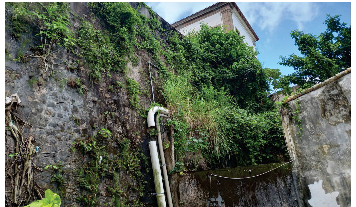
Figura 06 – Identificação de ruptura nas redes coletoras dos casarões históricos próximo ao Restaurante Coati.
