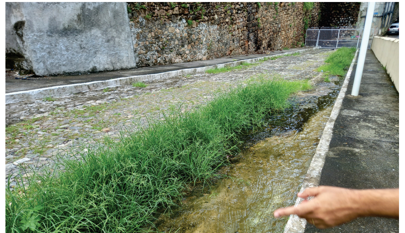
Figura 07 – Identificação de acúmulo de água ao longo da Ladeira da Misericórdia.
