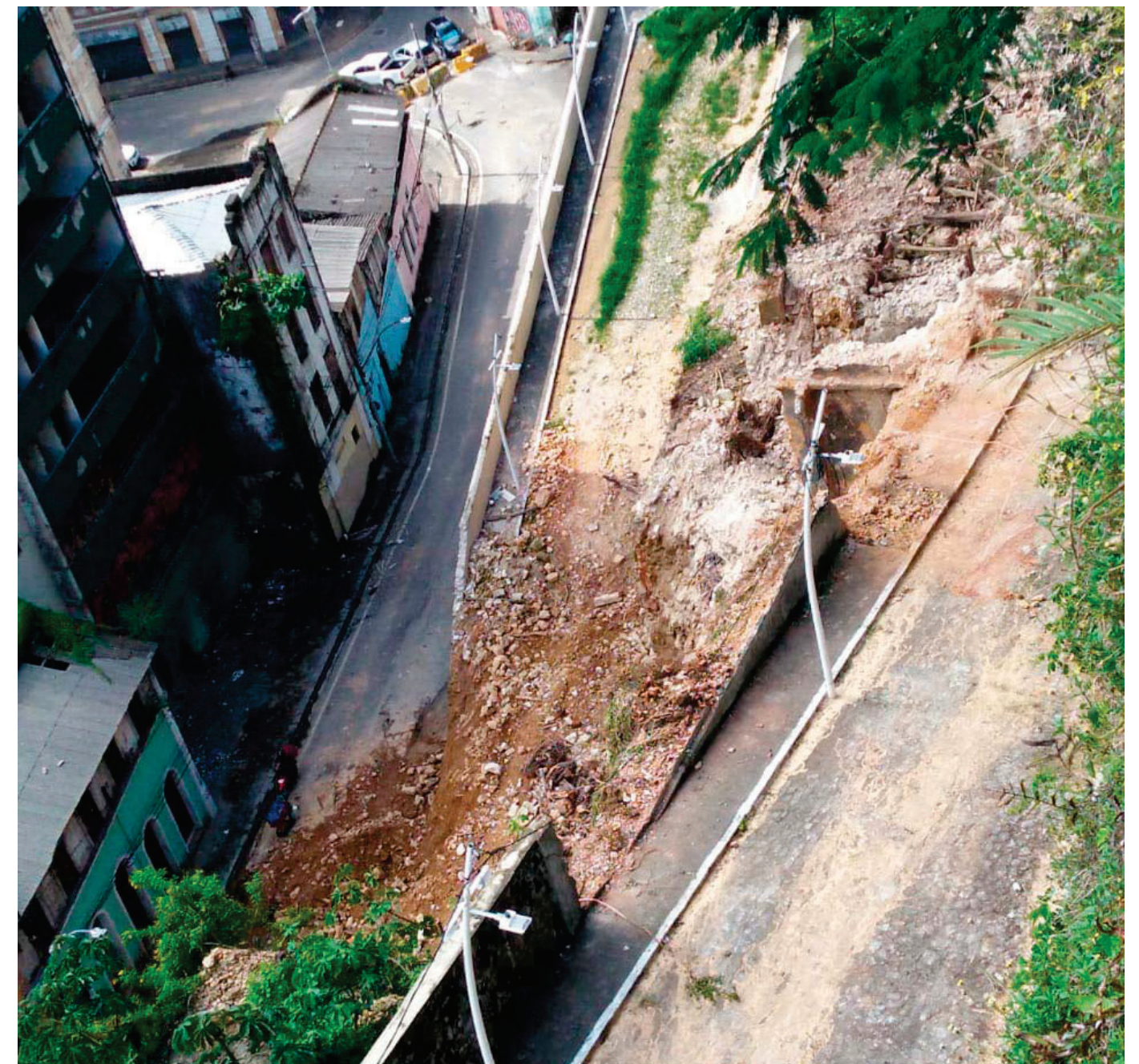
Figura 44 - Registro da situação atual da Ladeira da Misericórdia, após o desmoronamento da contenção e demolição das ruínas remanescentes.
