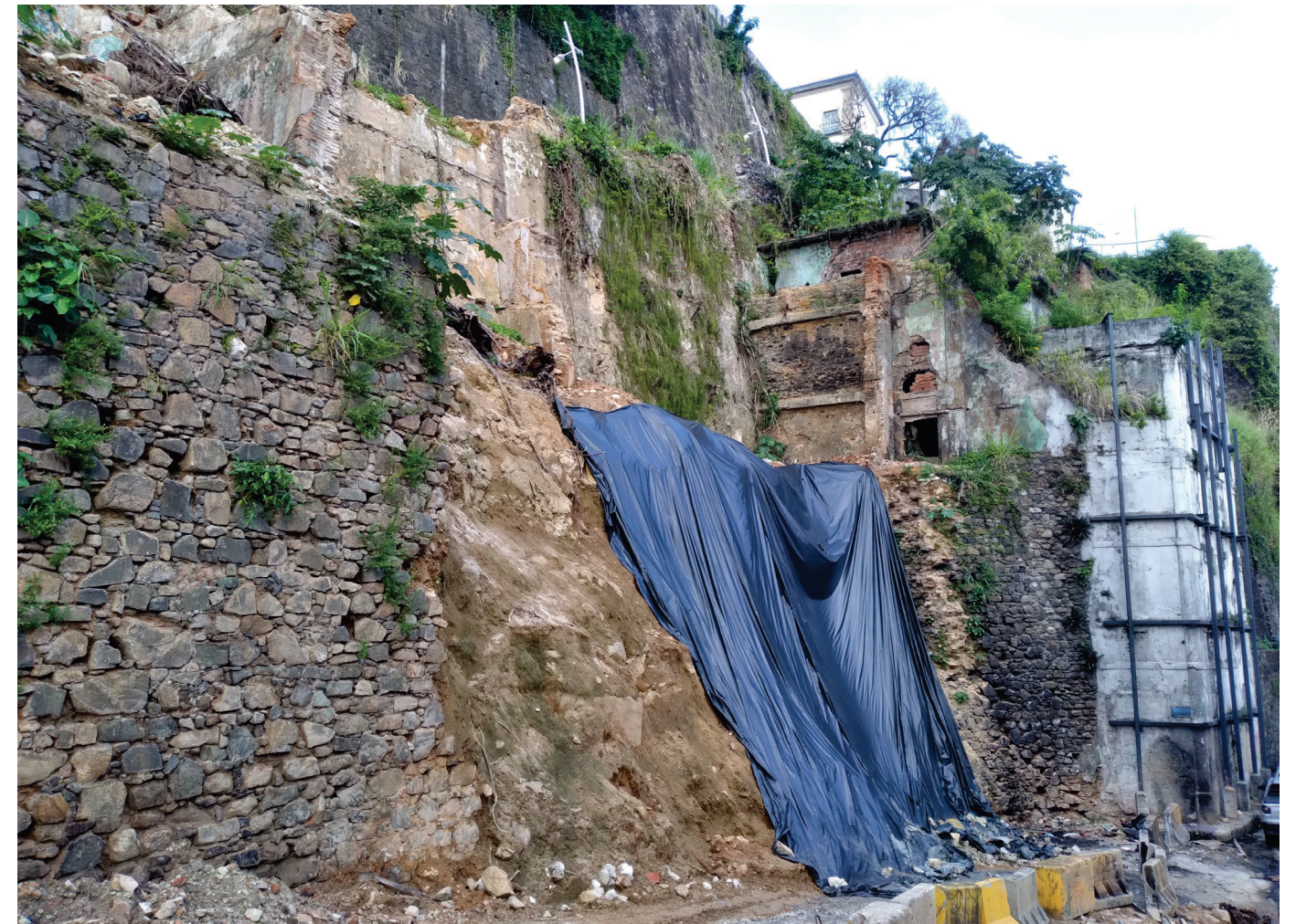
Figura 22 – Registro de trecho da contenção de pedra cujo recente desmoronamento acarretou na demolição das ruínas da Ladeira da Misericórdia.
