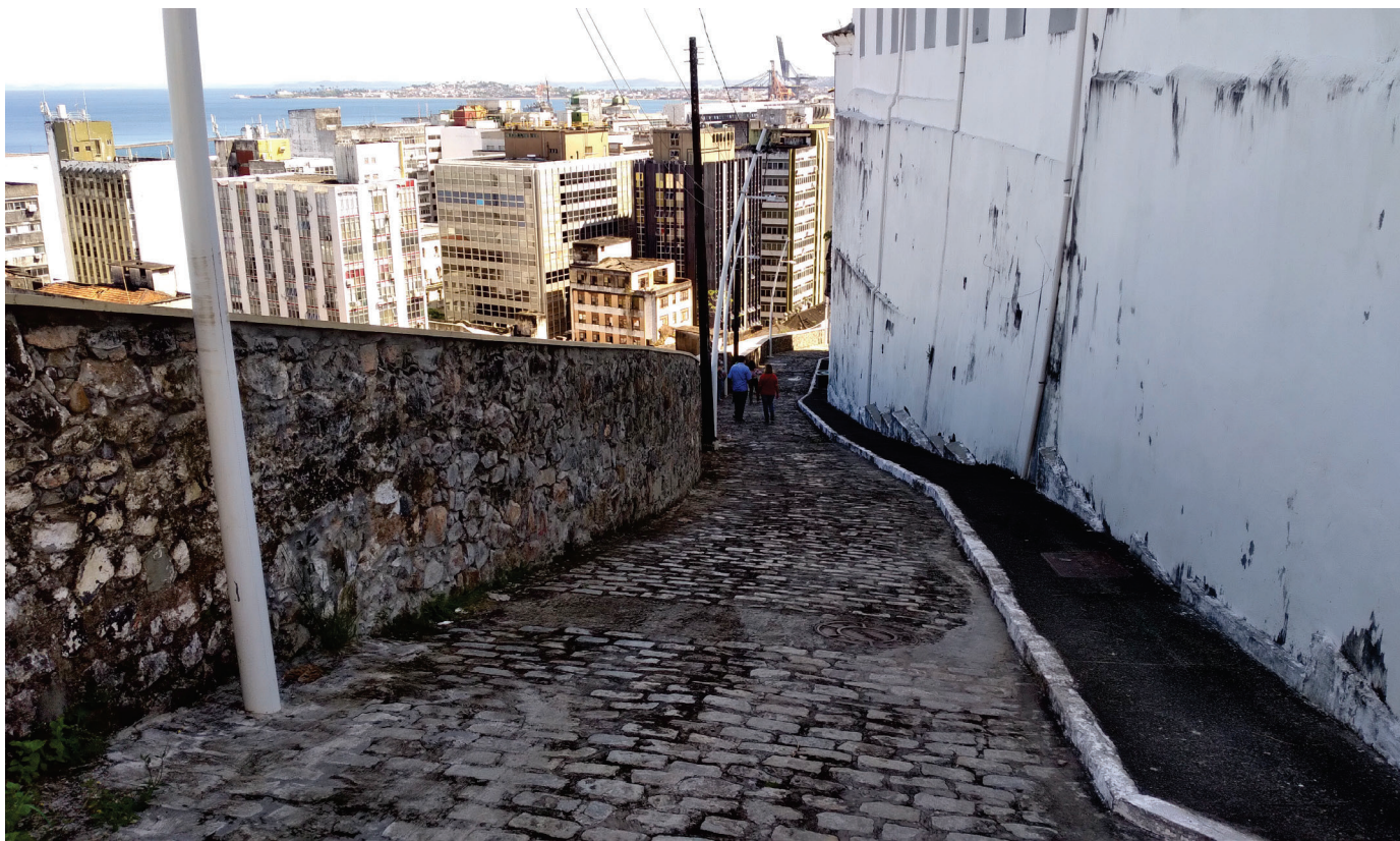
Figura 04 – Registro da pavimentação com argamassa irregular e meio fio desalinhado com pintura branca de pouca qualidade estética.
