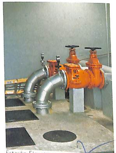
Estação Elevatória de Esgotos Itabuna, BA
