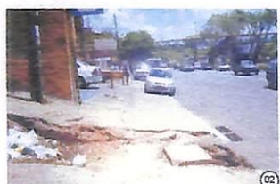
Av. Mário Leal Ferreira (Vale do Bonocô), passeio em mal
