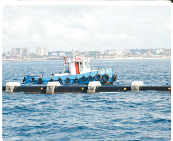
Afundamento do tramo do emissário submarino da Boca do Rio em fevereiro de 2009
