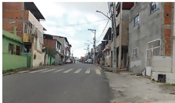
Figura 39 - Inadequação da calçada na Rua Bem-Te-Vi, limite entre as ZEIS Canabrava e Canabrava II. Fonte: FLMF, 2022.
