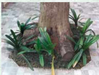
Fig. 18 - Errado: Poda de raízes de sustentação, causa de problemas estruturais.
