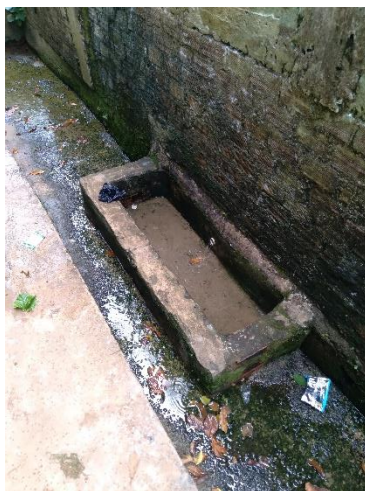
Figura 148 - Minadouro na Rua da Fonte, Padre Ugo Fonte: Autoria da equipe de campo, 12/2022
