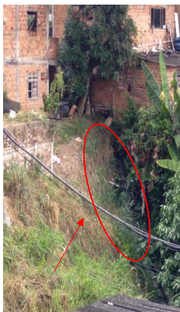
Figura 151 - Exemplo das condições do esgotamento sanitário: escoamento de esgoto a céu aberto em encosta
