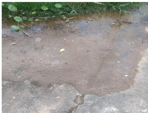
Figura 179 - Condições favoráveis a proliferação de vetores: caramuios. observados na Rua Araújo Pinho
