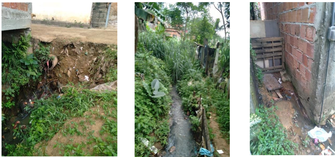
Figura 150 - Exemplo das condições do esgotamento sanitário: escoamento de esgoto a céu aberto
