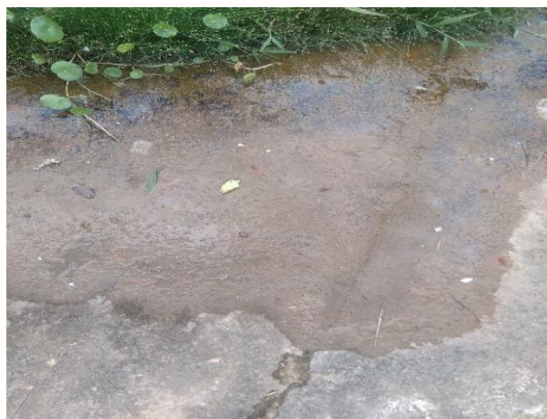
Figura 129 - Condições favoráveis a proliferação de vetores: caramuios. observados na Rua Araújo Pinho
