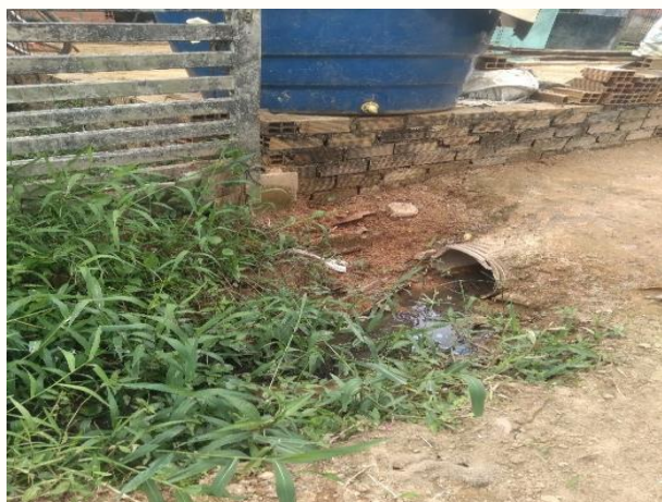
Figura 128 - Condições favoráveis a proliferação de vetores: esgoto a céu aberto próximo a recipiente utilizado para reservação de água
