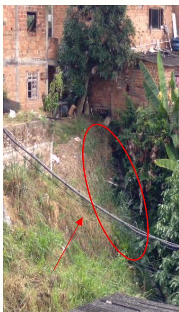
Figura 100 - Exemplo das condições do esgotamento sanitário: escoamento de esgoto a céu aberto em encosta
