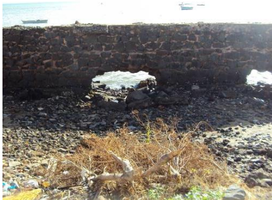
Figura 19 - Foto da contenção de pedra danificada (obra emergencial)
