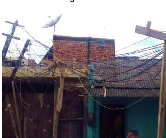
Figura 12 - Foto de ligações irregulares de energia
