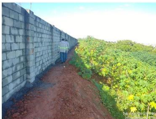
Foto 8.5 – Distância muro a topo de talude, vegetação de mamonas.
