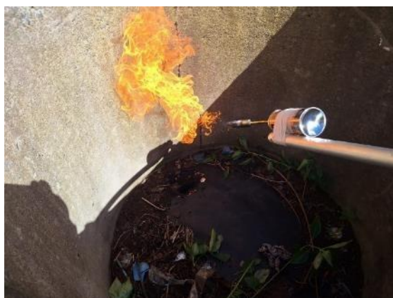
Foto 3.7: Terminal de dreno PVC teste de queima no DG 11 – campanha 03/05/24
