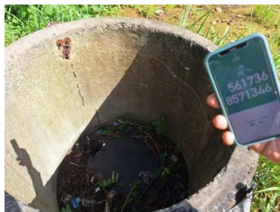
Foto 3.8: Terminal de dreno PVC teste de queima no DG 11– campanha 03/05/24
