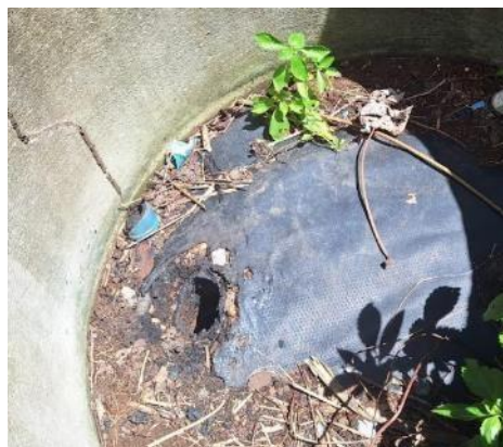
Foto 3.3 – Terminal de dreno PVC queimado –, campanha 27/04/24
