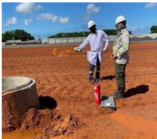
Foto 3.5: Terminal de dreno PVC teste de queima no DG 8– campanha 03/05/24
