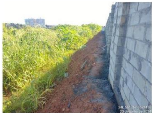
Foto 8.8 - Deslizamento de talude. Distância de muro ao topo de talude.
