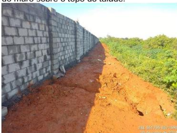
Foto 8.11 – Voçoroca provocada pela drenagem pluvial.
