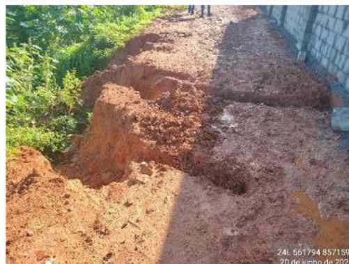
Foto 8.2 – Voçoroca provocada pela drenagem pluvial.
