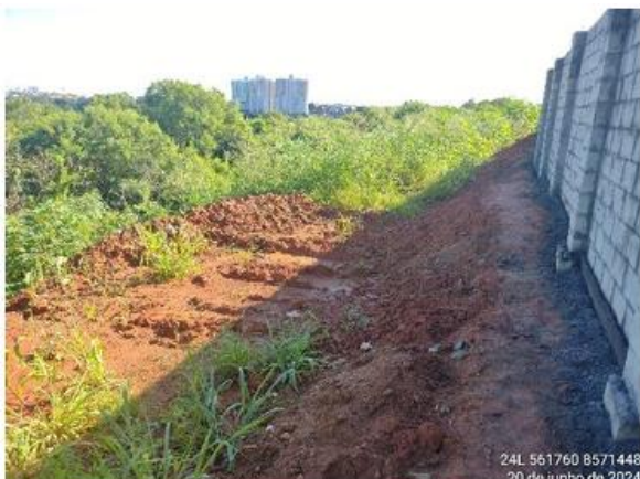
Foto 8.9 – Deslizamento do material de aterro do muro sobre o topo do talude.
