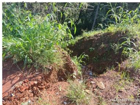
Foto 8.14 - Voçoroca provocada pela drenagem pluvial.
