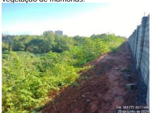
Foto 8.7 – Deslizamento de talude. Distância de muro ao topo de talude.
