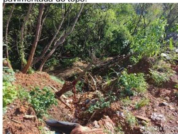
Foto 8.12 - Voçoroca provocada pela drenagem pluvial.
