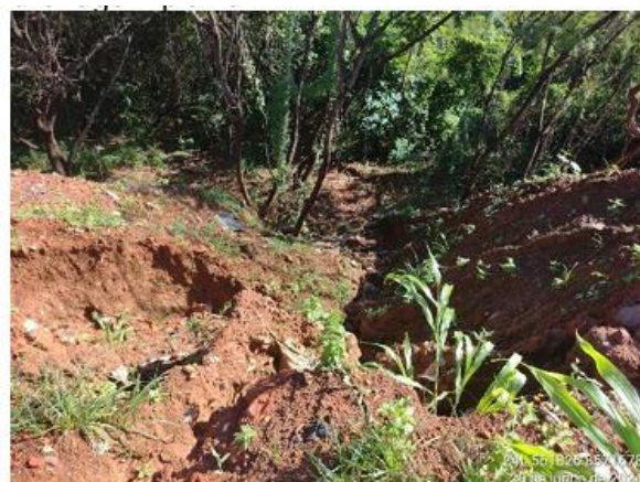
Foto 8.13 - Voçoroca provocada pela drenagem pluvial.
