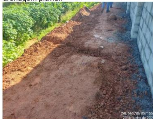
Foto 8.4 – Voçoroca provocada pela drenagem pluvial.
