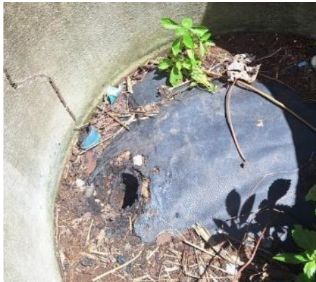
Foto 3.3 – Terminal de dreno PVC queimado –, campanha 27/04/24
