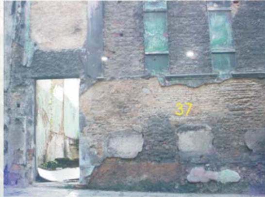
Fachada de imóvel em ruína nº 37 (Programa Rememorar II)
