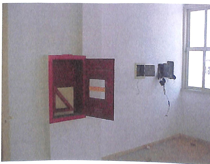
INST. ELÉT. E INCÊNDIO DANIFICADAS
