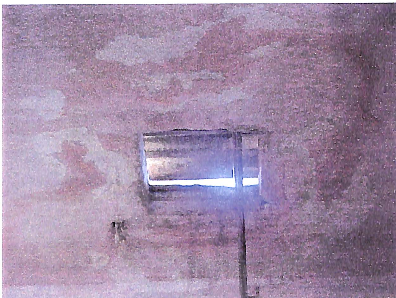
INFILTRAÇÃO LAJE CASA DE MÁQUINAS
