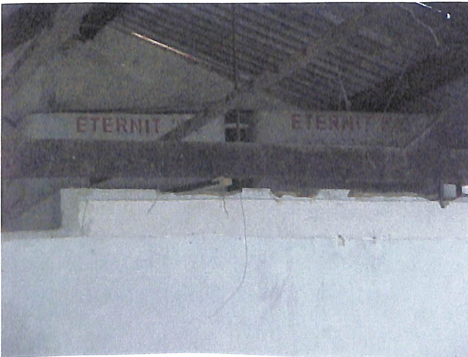
TANQUES ETERNIT NO 4º PAV.
