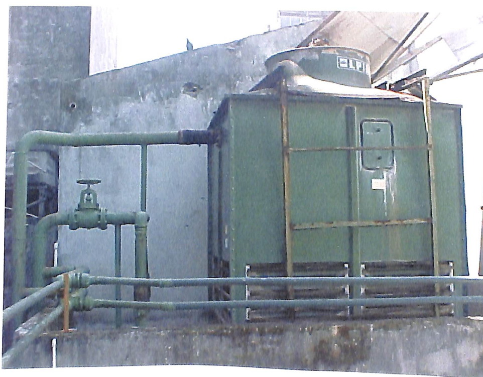
CENTRAL DE AR CONDICIONADO
