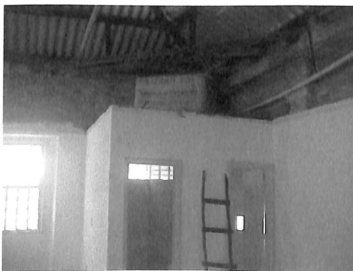
TANQUE ETERNIT NO 4º PAV.
