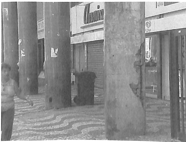
PILAR COM FERRAGEM EXPOSTA
