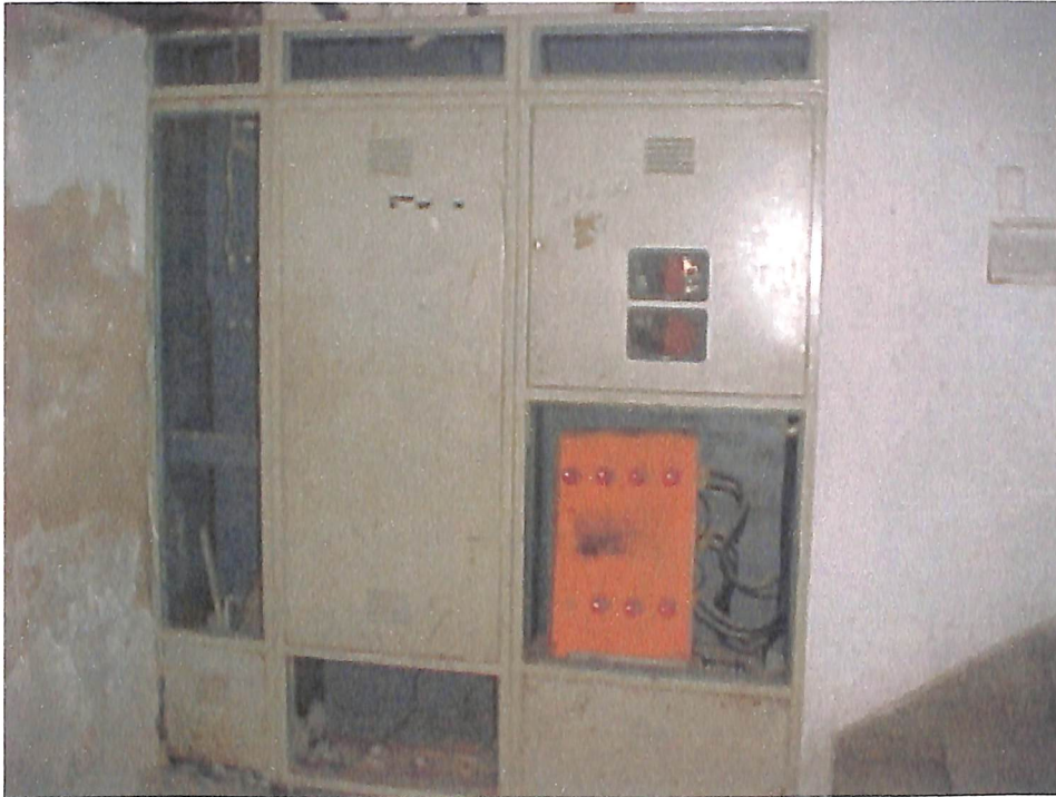
QUADRO DE ENTRADA DE ENERGIA
