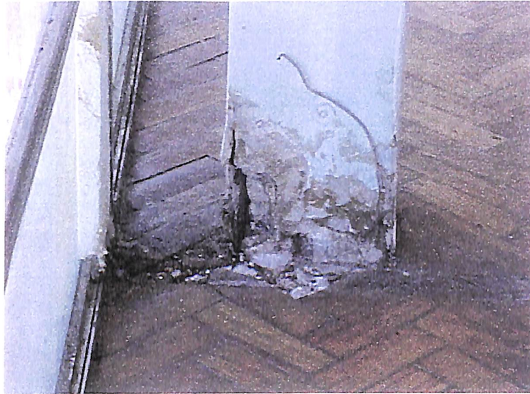
FERRAGEM EXPOSTA ( Infiltração pela esquadria )
