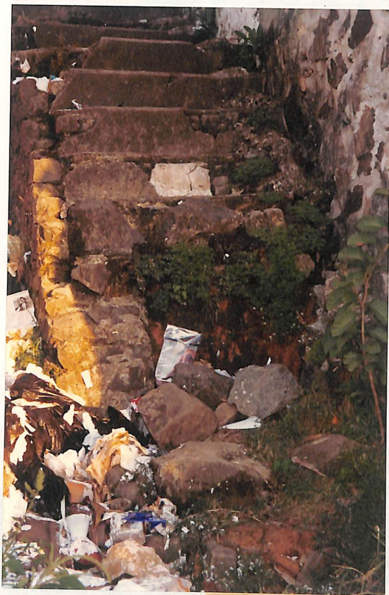
Escadaria de a- cesso ao 2º nível do mirante com trecho desabado
