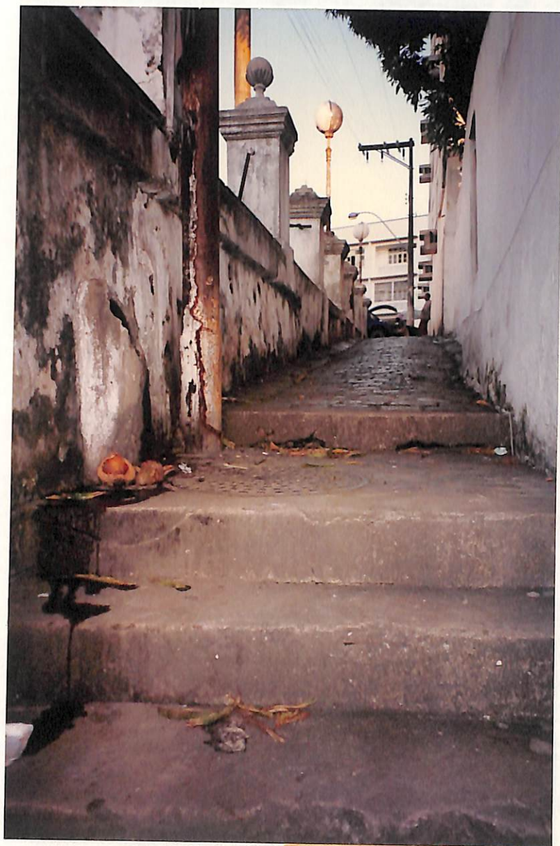
Vista parcial do acesso ao 2º ní- vel do mirante
