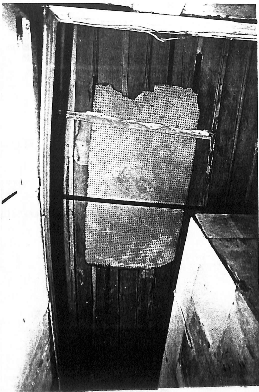
VISTA DO FORRO EM PESSIMO ESTADO.
