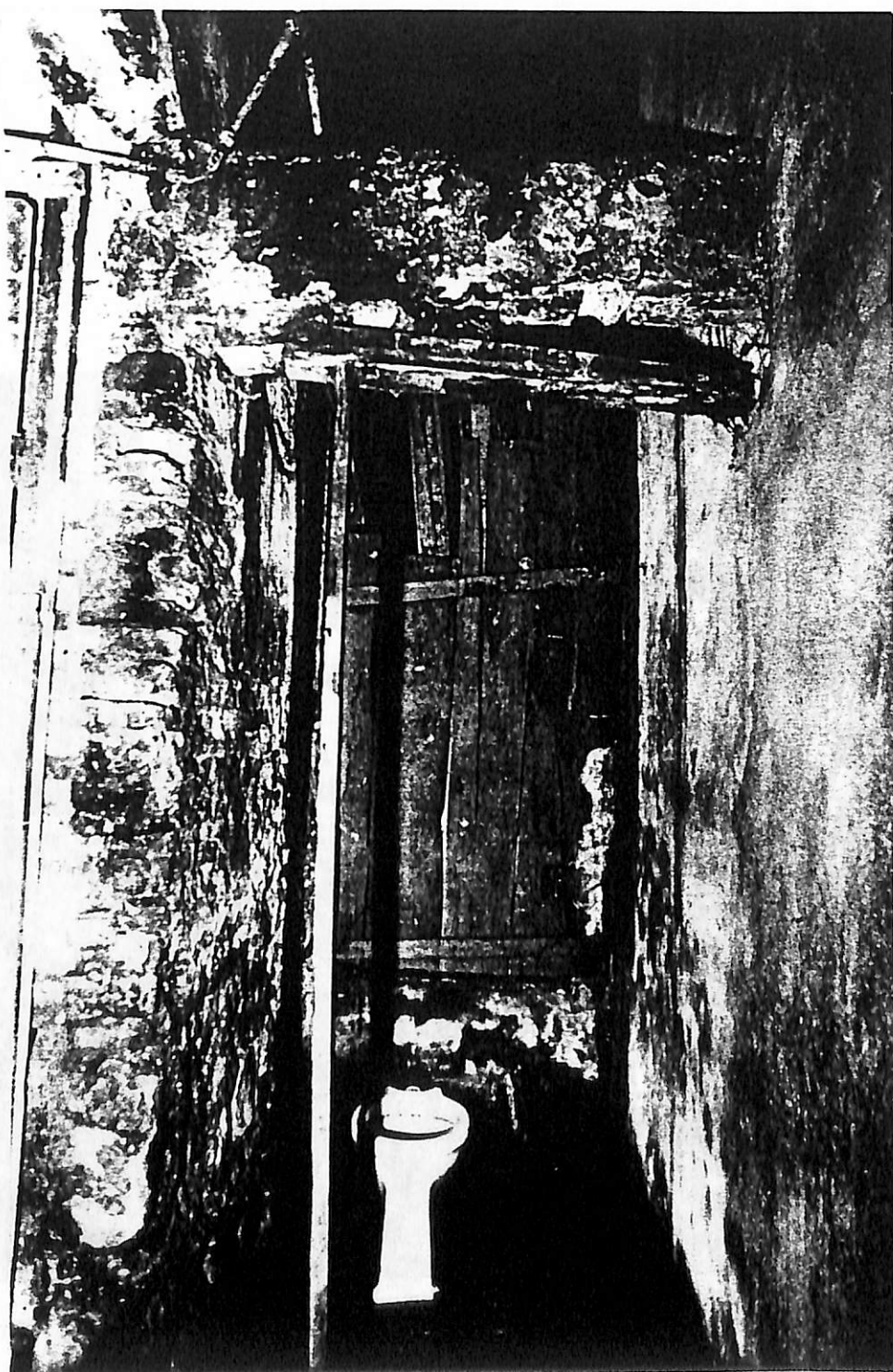
INSTALAÇÕES SANITÁRIAS, PRECÁRIAS.
