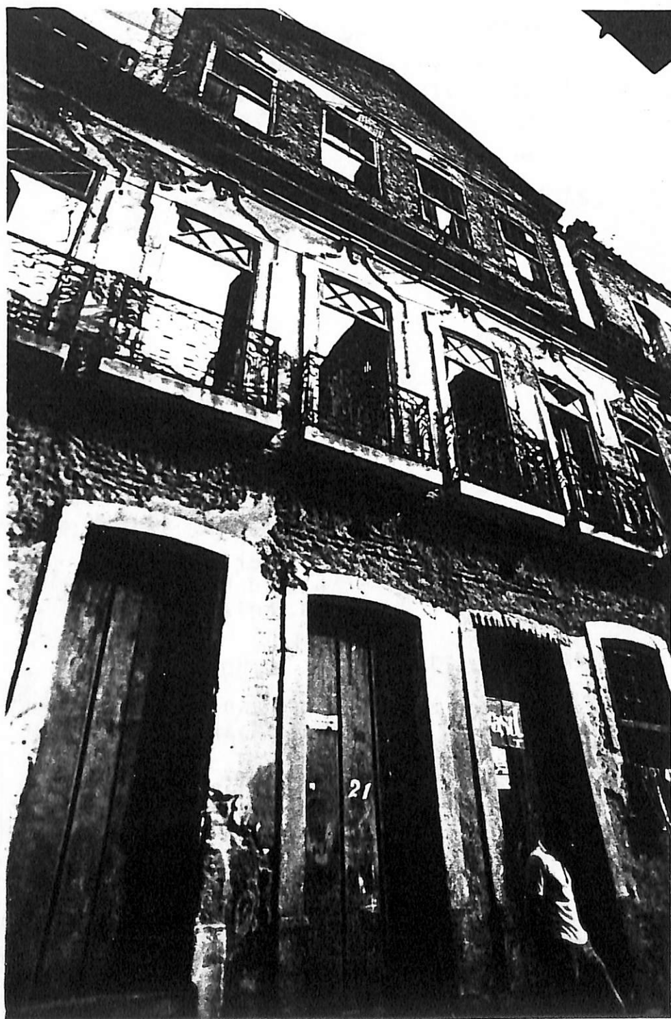
VISTA DA FACHADA, DESAPRUMADA, EM IMINENTE DESABAMENTO
