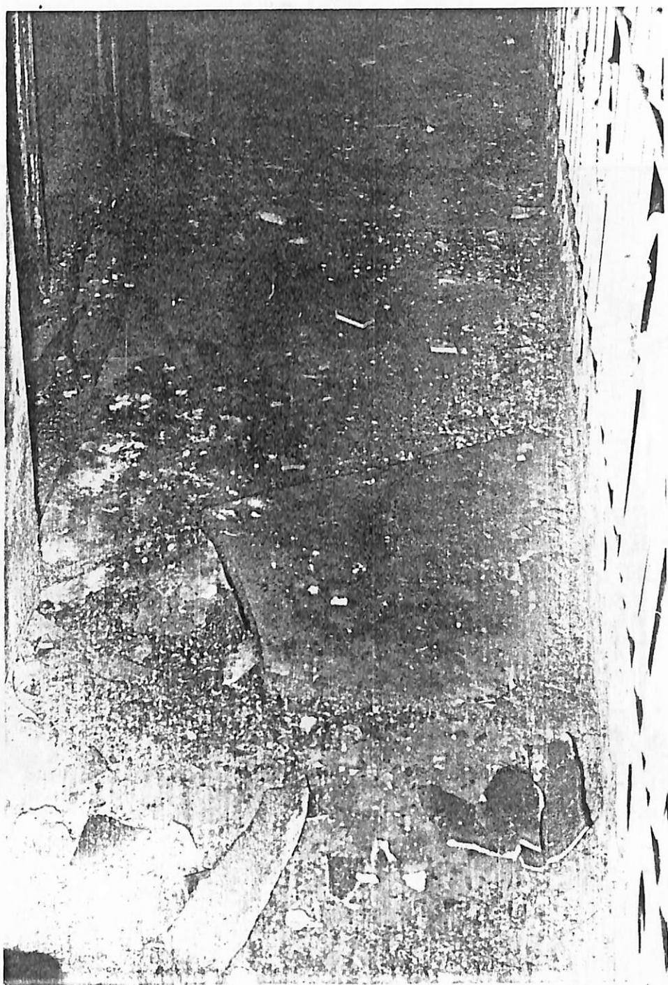
LESÃO DO PISO DE MÁRMORE DA CIRCULAÇÃO CENTRAL.
