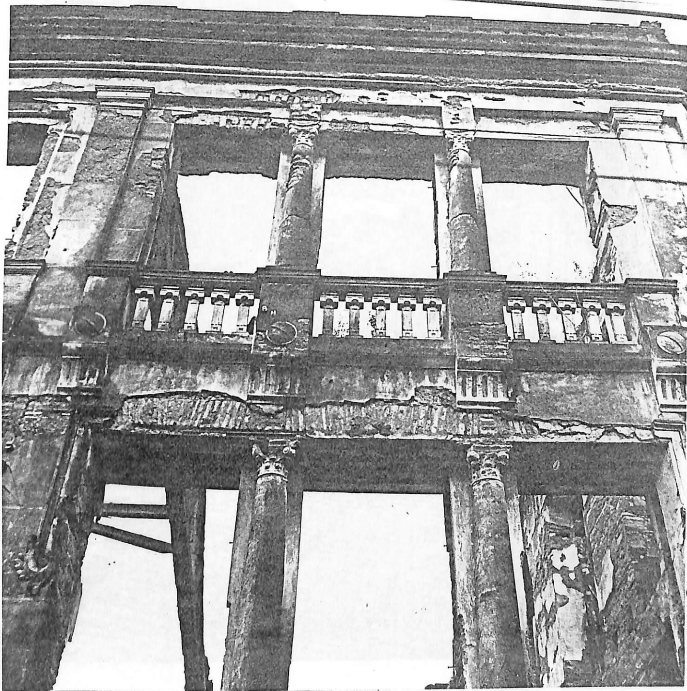
Detalhe da fachada após o incêndio antiga Rádio Excelsior rua Guedes de Brito
