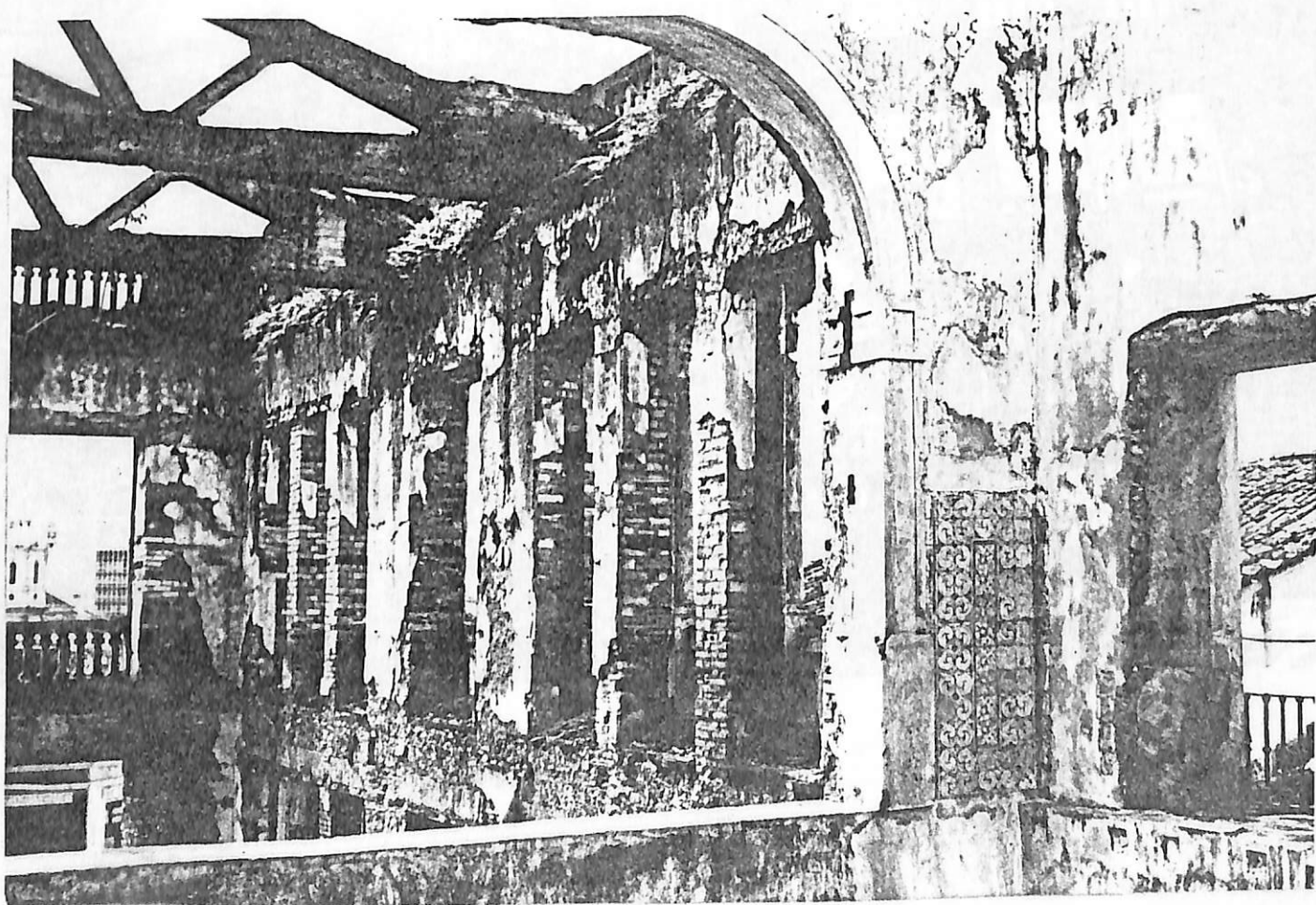
Detalhe área interna antiga Rádio Excelsior, após o incêndio
