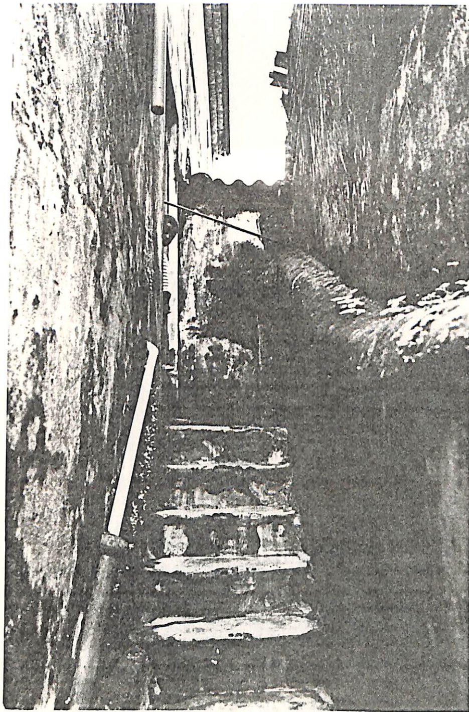
Escada de acesso ao banheiro refletindo a forte humidade presente.
