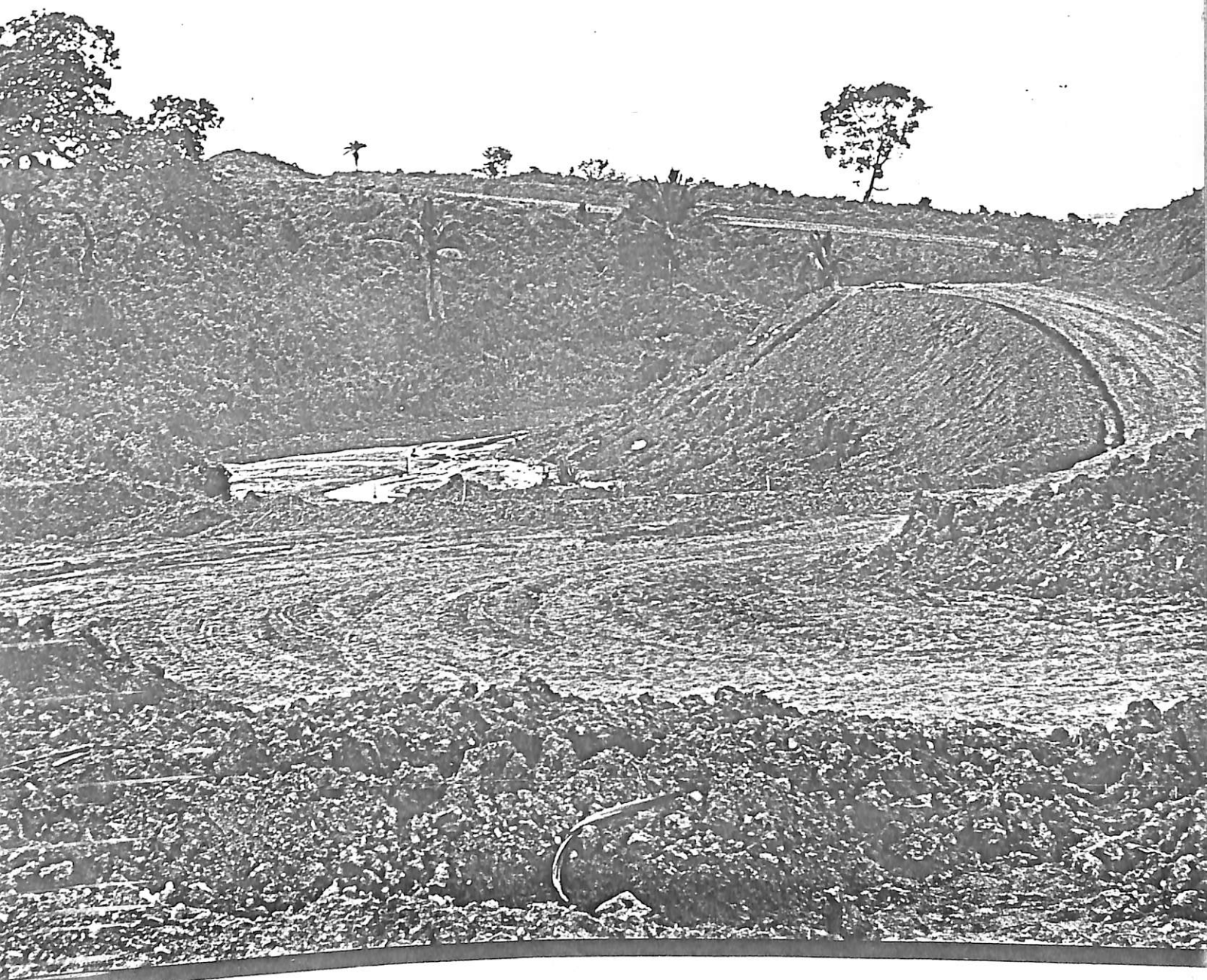
OBRAS DA TERRABRÃS. ASSOREAMENTO DO RIACHO MANÉ DENDE
