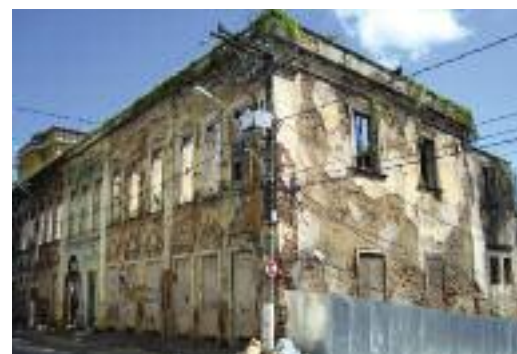
Imóvel em ruína/Centro Antigo Fonte: Arquivo ERCAS.
