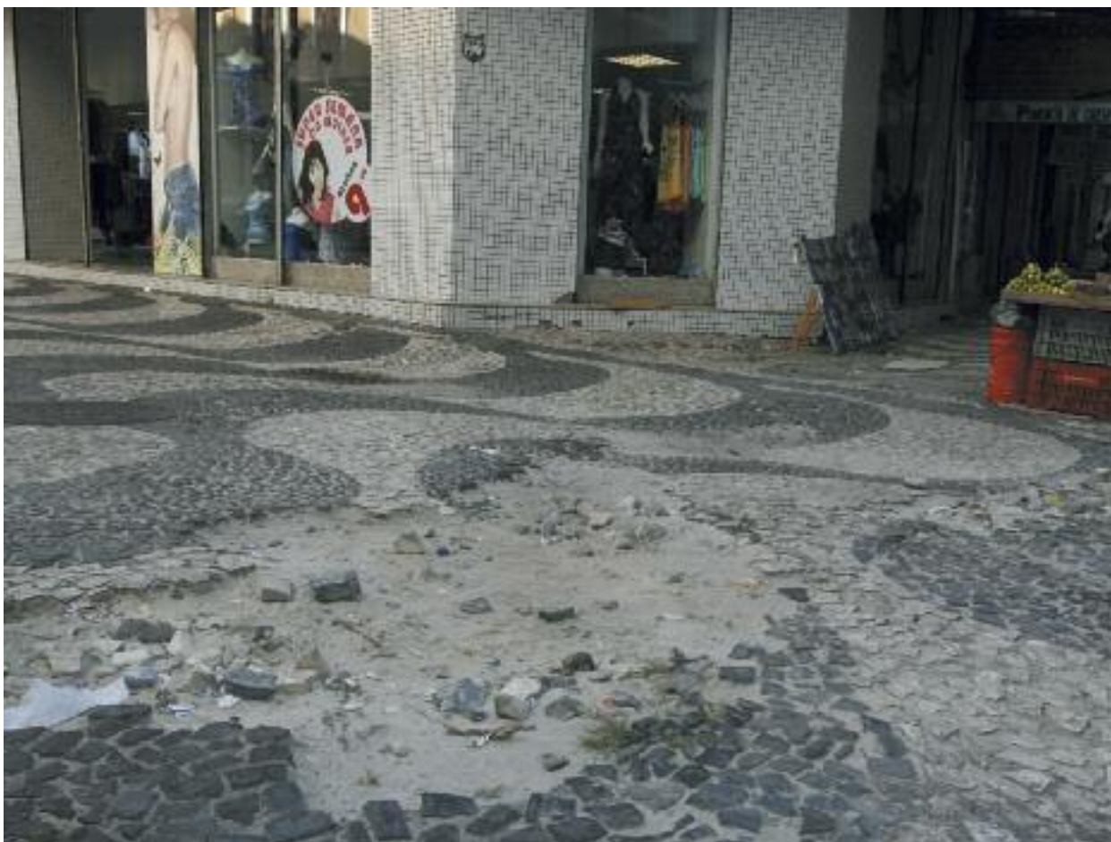
Foto 2 – Calçada degradada no Comércio. Fonte: Arisson Marinho/AGECOM.
