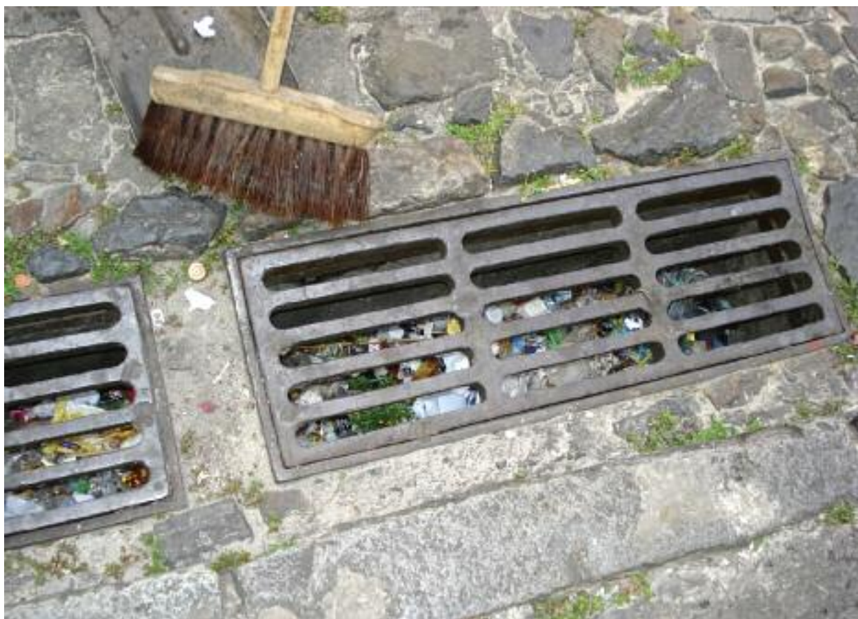
Foto 2 - Acúmulo de lixo em bueiro - Centro Histórico. Fonte: Arquivo ERCAS.
