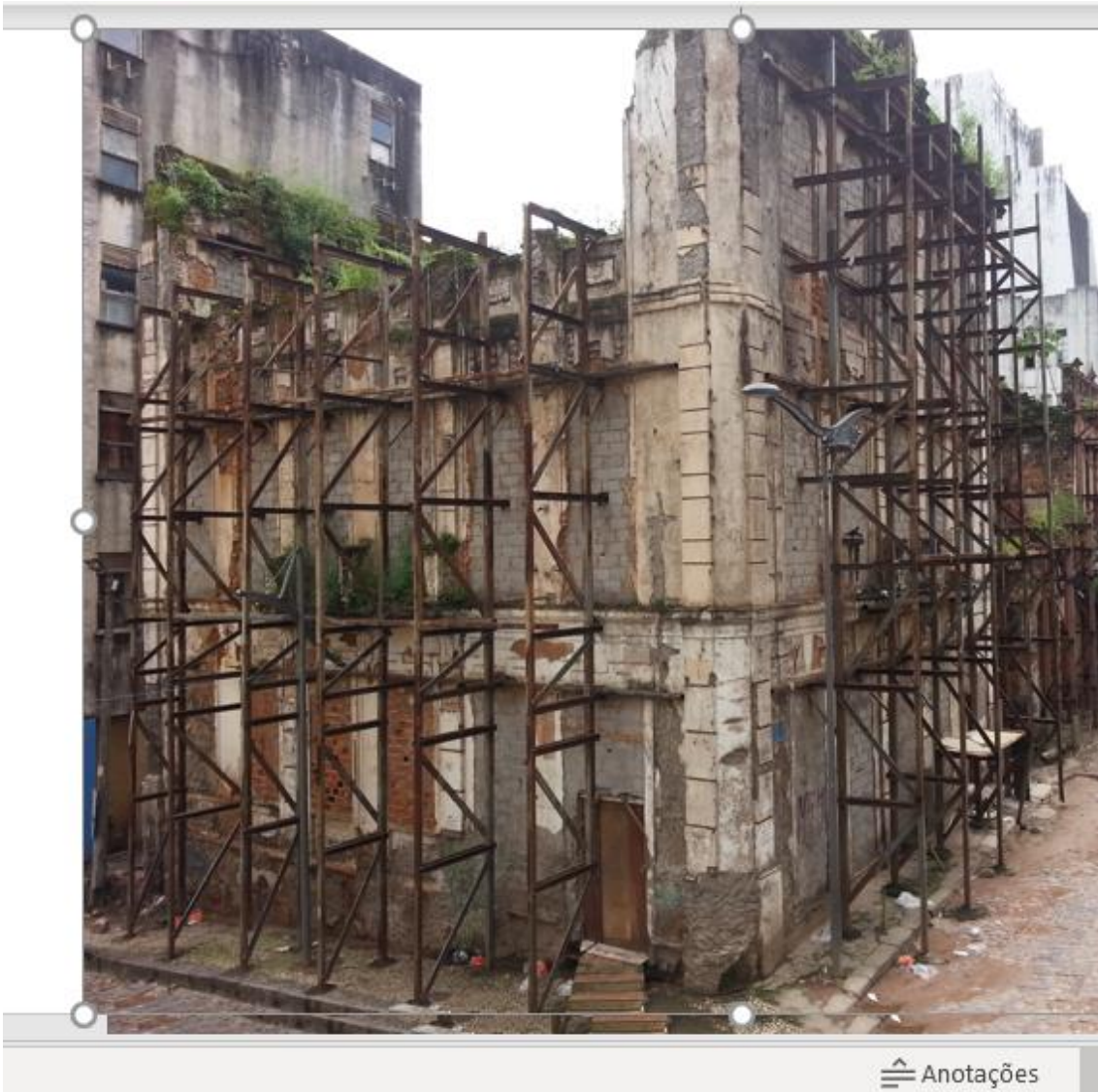
Imóvel arruinado no Comércio
