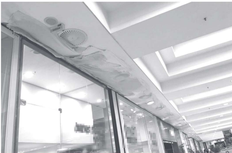
SUSTO Um pedaço de gesso caiu do teto e atingiu o ombro de um cliente. O barulho assustou funcionários e frequentadores
