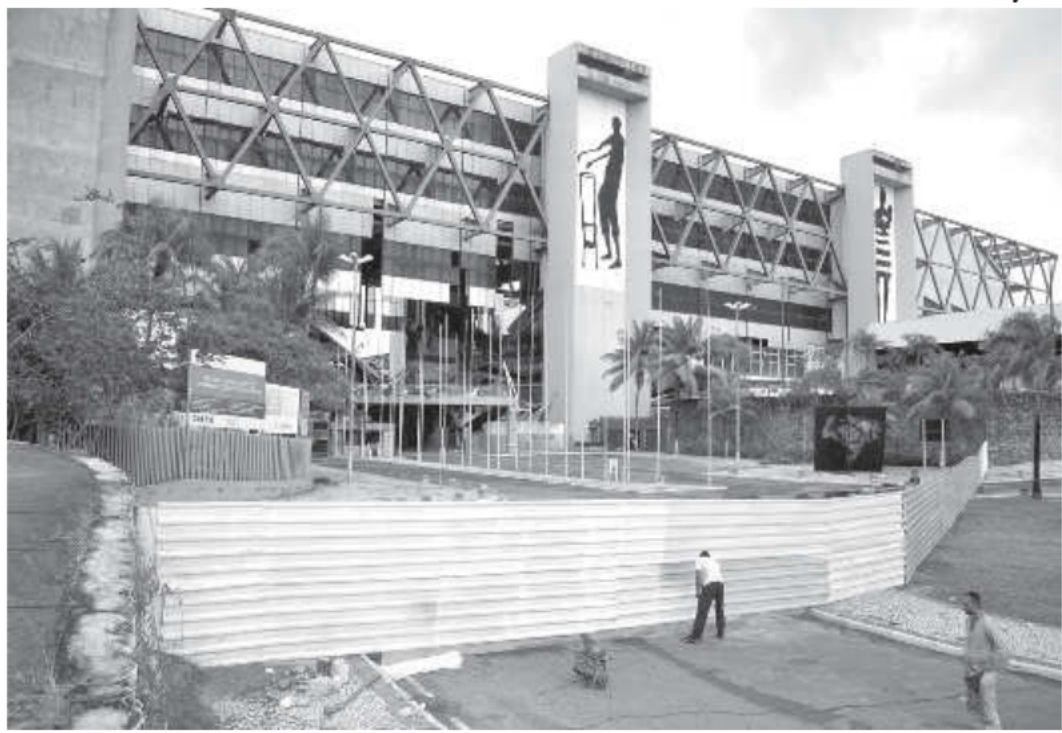
INDEFINIDO Estudo técnico vai emitir um laudo sobre a situação da estrutura do antigo prédio
