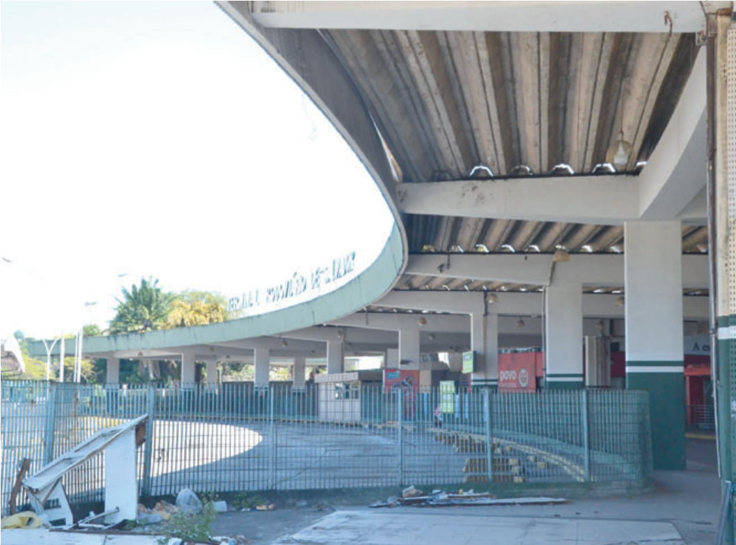
TERMINAL Equipamento agora segue cercado por lixo, mofo e resto de móveis
