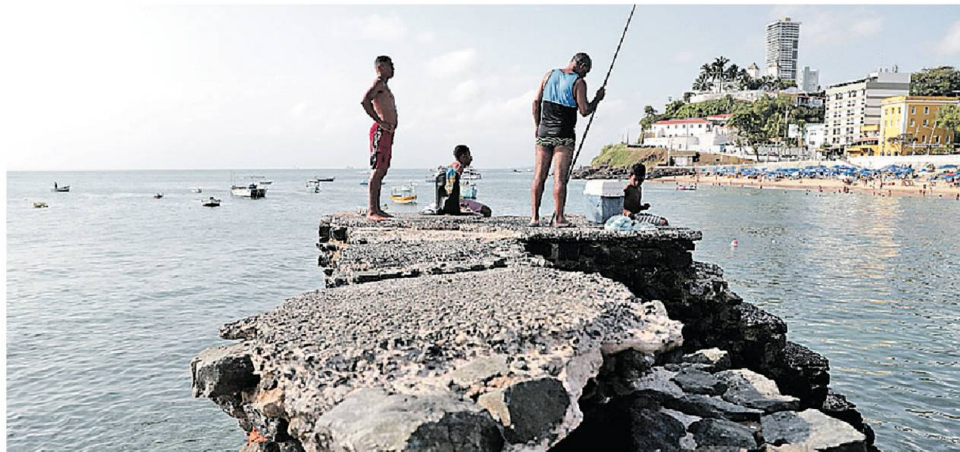
Com pedras e placas soltas sobre o cais, o estado da estrutura histórica preocupa frequentadores da região, que temem o risco de acidentes
