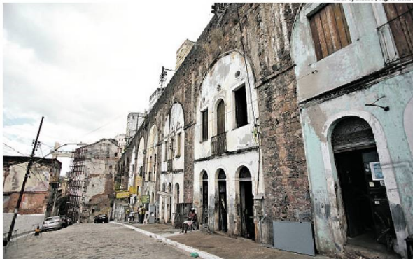
Arcos têm degradações na estrutura e em instalações elétrica e hidrossanitária
