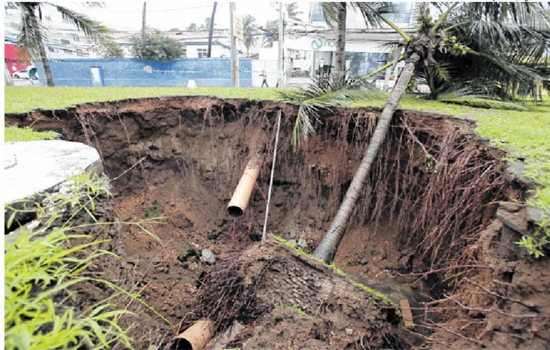
Rompimento na rede de drenagem e esgoto abriu cratera e derrubou um coqueiro na Av. Adhemar de Barros
