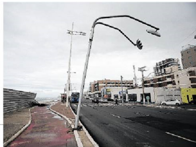
Semáforo quebrado pela ação do vento na Pituba
