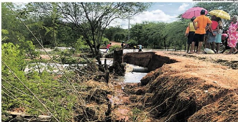
Pontes e bueiros foram levados pelas águas e diversas estradas estão intransitáveis por causa dos estragos
