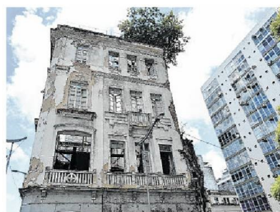
Como os principais, imóveis vizinhos, na Rua Portugal, que estavam abandonados e traziam riscos à população, serão reformados
