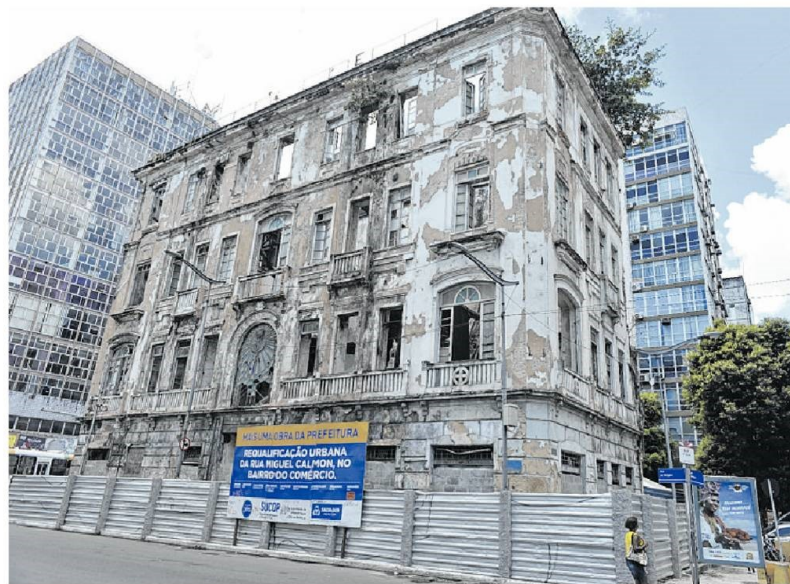
Bem em frente à Praça Cairu e o Mercado Modelo, esta será a moradia da Casa da História de Salvador e Arquivo Público Municipal
