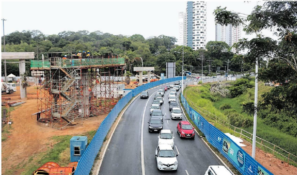
Autorização é para o manejo da fauna referente às obras de implantação do modal e a licença para as intervenções no canal do Rio Camarajipe
