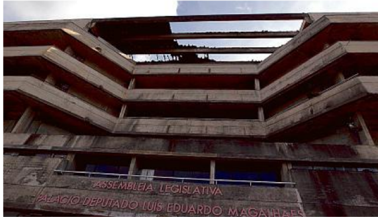
Cobertura parcialmente destruída pelo fogo; intervenções deverão ser feitas até a retomada das atividades
