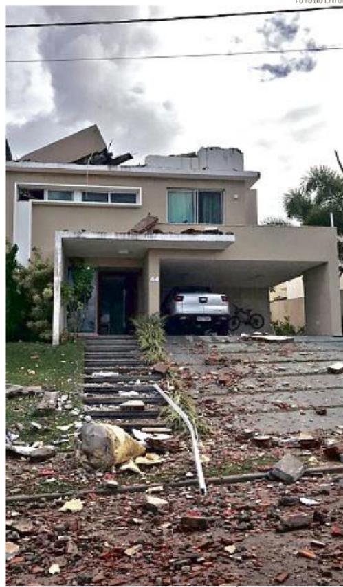
Aquecedor explode e destrói laje do imóvel, na Área 1 de Alphaville
