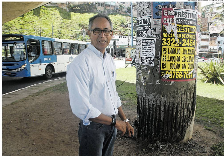
Engenheiro Edson Almeida diz que é preciso repor o aço perdido e retirar o concreto deteriorado para a recuperação
