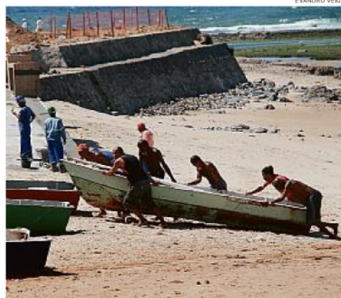
Antes de obra maior, lugar recebe muro de alvenaria para conter erosão
