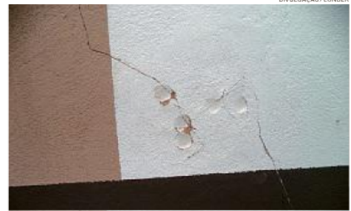
Há rachaduras nas paredes externas e internas dos imóveis
