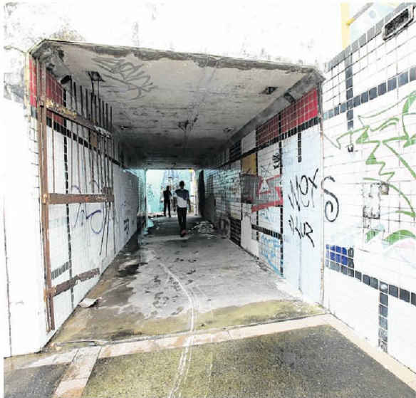
Pedestres reclamam de estrutura ruim na passagem subterrânea em Amaralina
