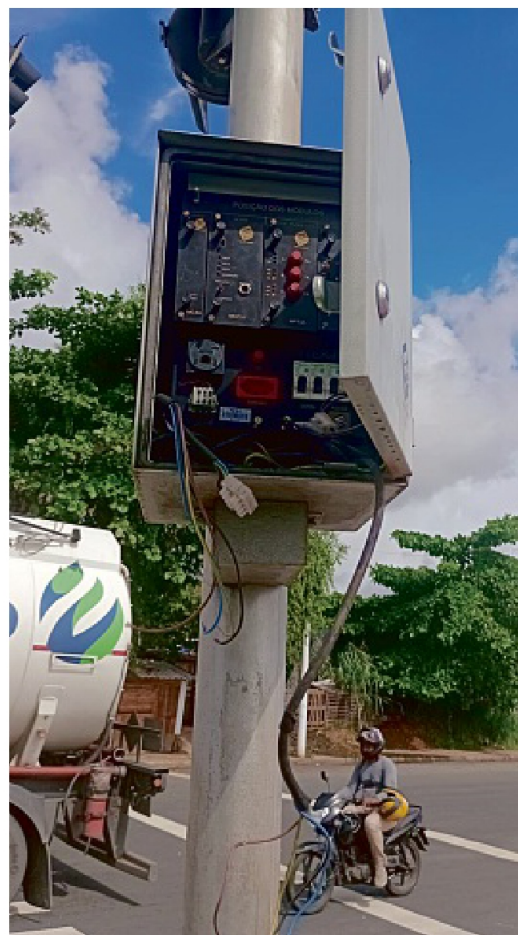
Semáforos em Salvador têm sido alvo de furtos de cabos de cobre, principalmente na madrugada, o que provoca falhas no funcionamento
