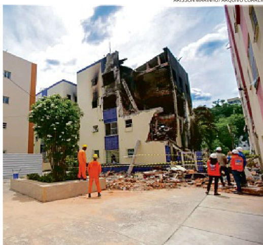
Órgão informou que a demolição foi recomendada em parecer técnico
