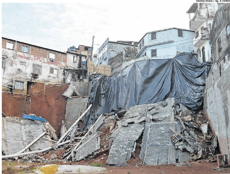
Primeiro desabamento colocou sete casas em risco, mas duas famílias só deixaram as residências ontem
