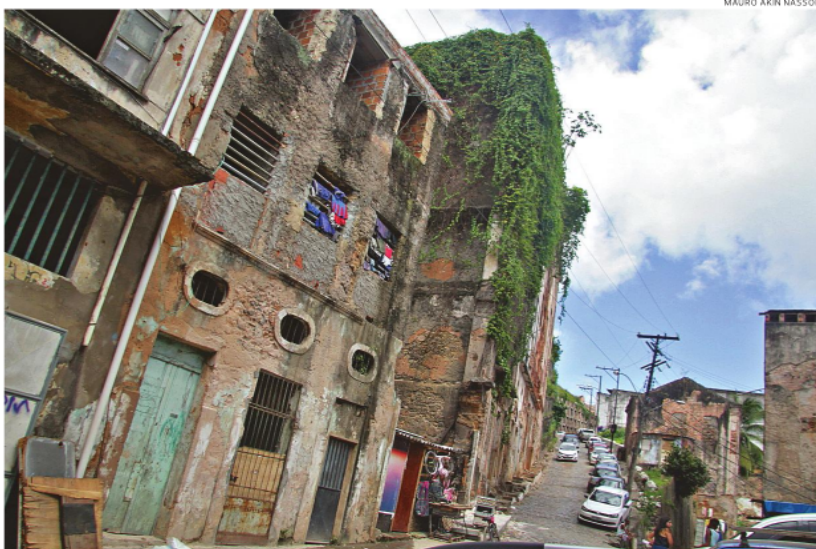
Rua do Julião, localizada no Comércio, tem sequência de casarões com risco de cair. Alguns já desabaram
