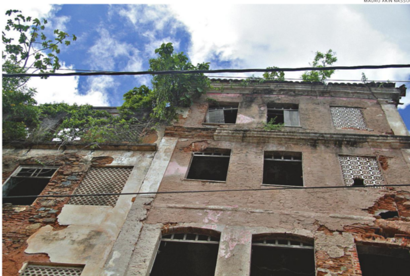
Prefeitura já identificou 122 imóveis sob risco. Alguns imóveis estão, literalmente, caindo aos pedaços
