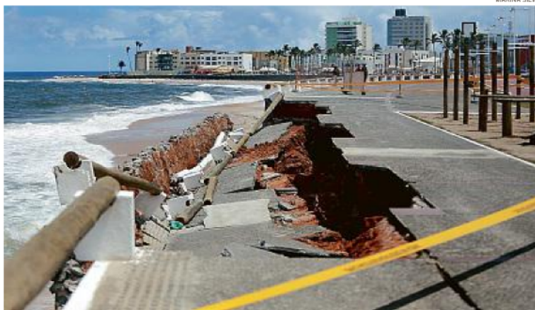
Trecho do calçadão que desabou foi interditado pela Defesa Civil; obras ficarão prontas em três meses
