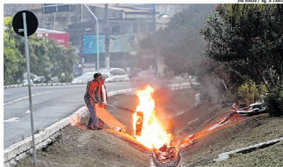
CRIME | A cena, registrada na avenida Vasco da Gama, é recorrente em Salvador: após serem furtados, cabos de energia elétrica são queimados para possibilitar a extração de cobre, de alto valor comercial. Resultado: ruas sem iluminação e prejuízos
