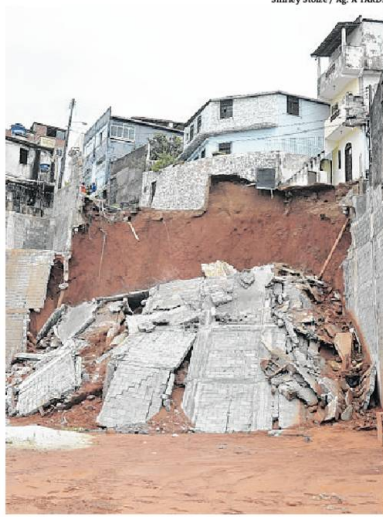
Desabamento comprometeu acesso dos moradores
