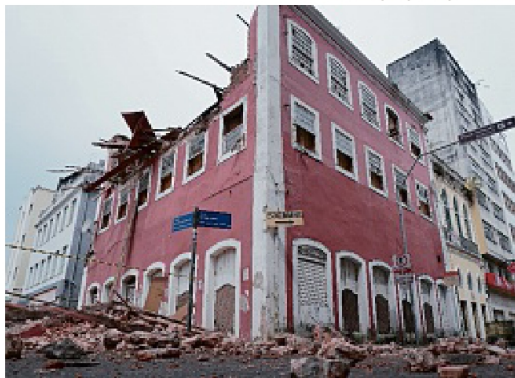
Laje e terceiro andar do prédio do Colon desabaram na quinta-feira
