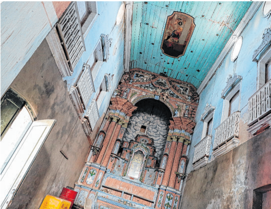
Igreja dos 15 Mistérios sofre com desgaste na estrutura e está fechada há uma década
